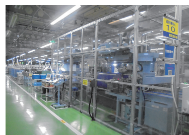
自動成形機+自動組み立てライン
